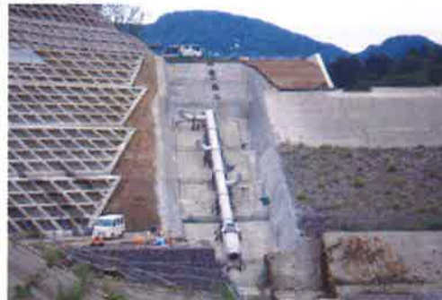
取水設備配管状況（関連工事）
